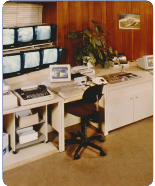
Der Kontrollraum der Altstadtgarage in den 80er Jahren
